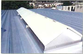
屋上排煙ハッチ遮熱
