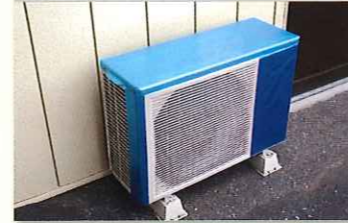
空調機室外機
